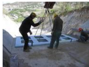
Fot. Montaż wagi błota
